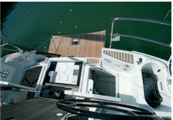
Raum. Tiefe Backskisten und in der Mitte noch Platz für den Generator
